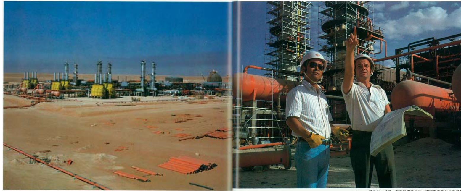
アルジェリア、ガス処理プラント
